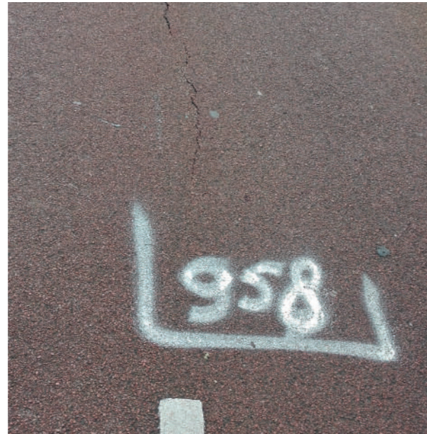
Zdjęcie 47 Oznaczenie spękania warstwy ścieralnej na drodze dla rowerów do naprawy. Holandia
